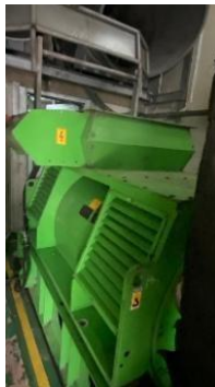
Gambar 2.1 Generator Mesin Gas Unit 5 PLTMG PT. Maxpower Indonesia ( Sumber: Dokumen Pribadi )
