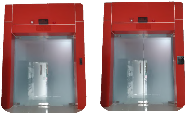
Gambar 3.4 Visualisasi perangkat Akses Kontrol pada pintu Ruang 2, PT.Telkom Indonesia
