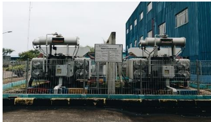
Gambar 1. Transformator PLTU Tanjung Balai Karimun
