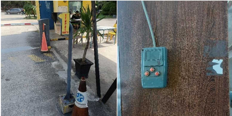
Gambar 1. Akses Masuk dan Keluar Serta Kontrol Palang Pintu
