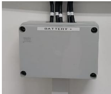
Gambar 2. 3 Combiner Box [Dokumentasi Pribadi]
