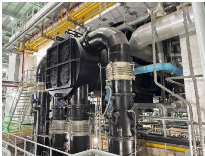
Gambar 4. Kondensor Unit 4 (Dokumentasi Lapangan)
