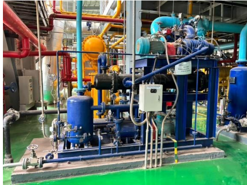
Gambar 6. Pompa Vakum Roots (Dokumentasi Lapangan)
