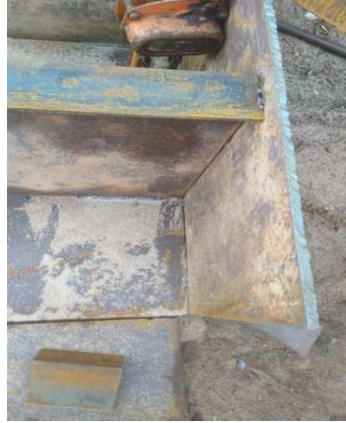
Gambar 11 Kondisi Permukaan Pelat/Kampuh Las Yang Tidak Dibersihkan Sebelum Pengelasan
