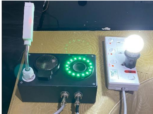
Gambar 24. Pengujian Relay Output Lampu
