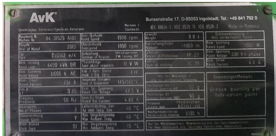
Gambar 19. Name plate generator Avk Type DIG 142
