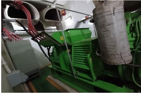
Gambar 3. Generator Avk Type DIG142 PLTMG Maxpower Panaran.
