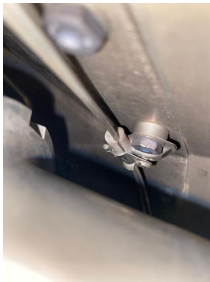
Gambar 12: Foto Fire Sensing Element (51226-051) Setelah Dipasang
