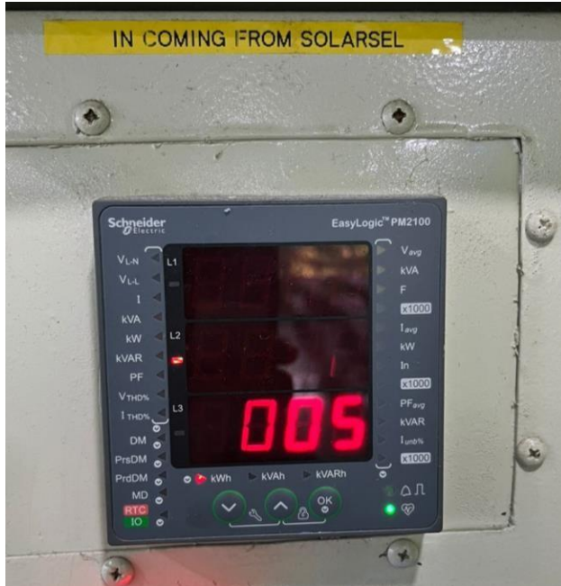
Gambar 5. kWh Meter [Dokumentasi Pribadi]
