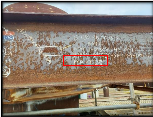
Gambar 10. Efek Data Straightness pada girder G1830PSA0023
