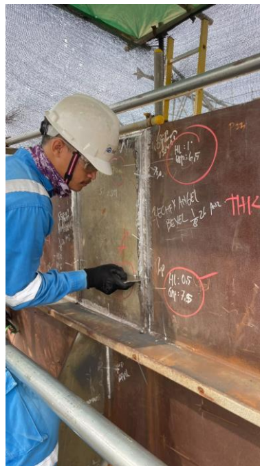
Gambar 3 : Pengukuran dimensi indikasi undercut pada spesimen posisi 3G dan 4G menggunakan welding gauge Cambridge
