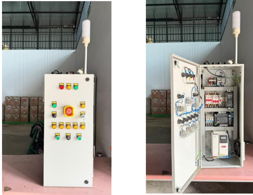
Gambar 4.3 Instalasi PLC di dalam Panel
