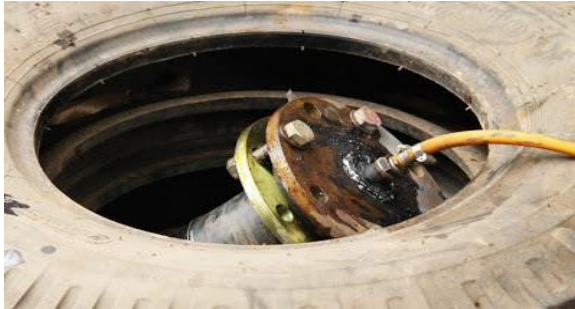
Gambar 4.7. Contoh kebocoran yang keluar dari flange
