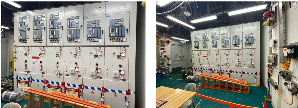
Gambar 3 Kondisi Aktual HV Room (Switchgear Room) dengan Proteksi A-60 (a) Panel Switchgear SG-116101 (b) Tampilan Keseluruhan Ruangan
