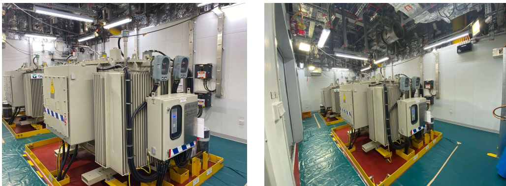
Gambar 2 Kondisi Aktual Transformer Room dengan Proteksi H-60 (a) Unit Transformator DTR-116102 (b) Tampilan Keseluruhan Ruangan
