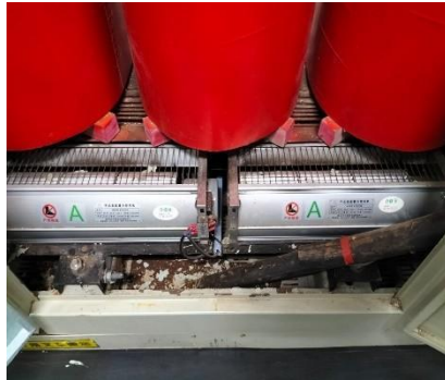
Gambar 3. Kipas Trafo Kering
