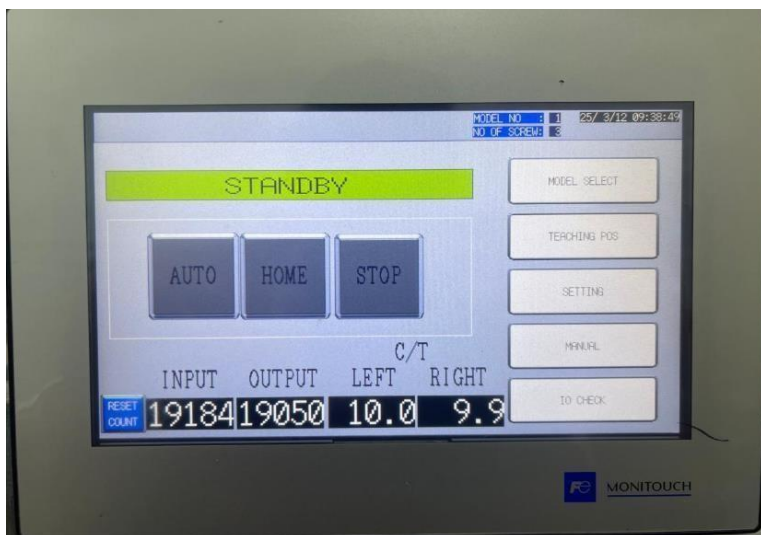
Gambar 61 Display HMI Mesin Standby
