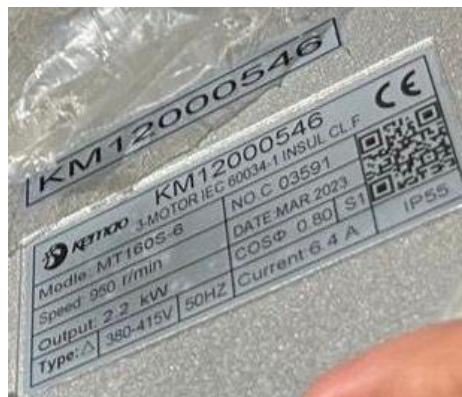
Gambar 13. Nameplate Motor Fan Radiator
