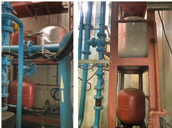
Gambar 9. Tangki Ekspansi pada Unit Mesin
