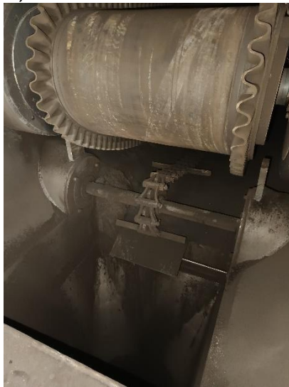
Gambar 4 Cleanout Conveyor (Sumber: Dokumentasi Pribadi)
