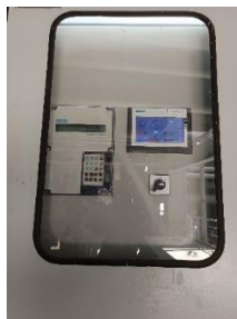
Gambar 5 Junction box (Sumber: Dokumentasi Pribadi)
