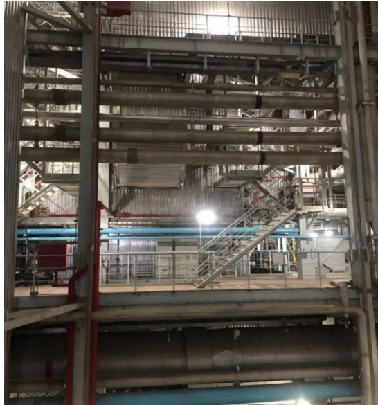
Gambar 3. Boiler PLTU PT Bintang Alumina Indonesia (Sumber : Dokumentasi Pribadi)
