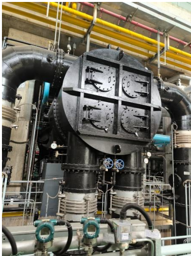
Gambar 7. Kondensor PLTU PT BAI
