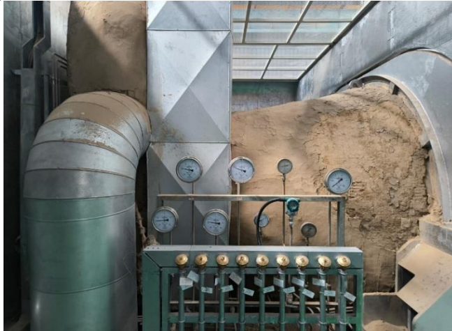
Gambar 4. Turbin uap unit 4 PLTU PT Bintan Alumina Indonesia
