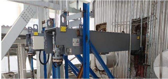
Gambar 9. Posisi Sootblower Pada Economizer
