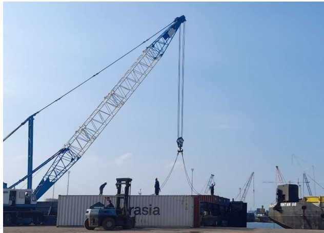
Gambar 1.2 Supir forklift yang tidak menggunakan safety helmet pada saat proses loading unloading peti kemas di Pelabuhan Batu Ampar Batam
