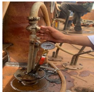
Gambar 2. Pressure Gauge yang digunakan pada pengujian Air Pressure Test
