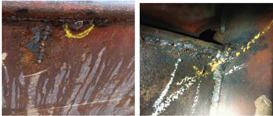
Gambar 4. 4 Hasil Pengujian Air Pressure Test pada Area yang Terjadi Kebocoran (Gambar Pribadi)
