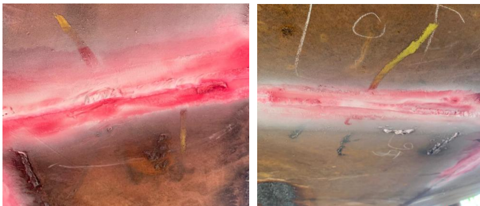
Gambar 4. 13 Hasil Akhir Setelah Dilakukan Perbaikan Dan Dilakukan Pengujian Ulang Tidak Ditemukan Lagi Cacat Permukaan Pada Hasil Pengelasan (Gambar Pribadi)
