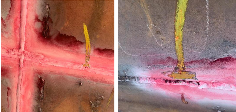
Gambar 4. 11 Hasil Pengujian Penetrant Test yang Menemukan Cacat Permukaan Pada Area Pengelasan Yang Melebihi Batas Toleransi (Gambar Pribadi)
