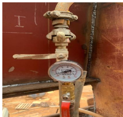
Gambar 2. 3 Pressure Gauge(sumber: Gambar Pribadi)
