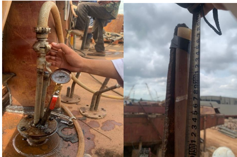
Gambar 3. 9 Mengisi Udara pada Tanki dengan Tekanan 0,2 Bar Menggunakan Pressure Gauge dan 1,8 – 2 M Menggunakan Menometer Air (Gambar Pribadi)
