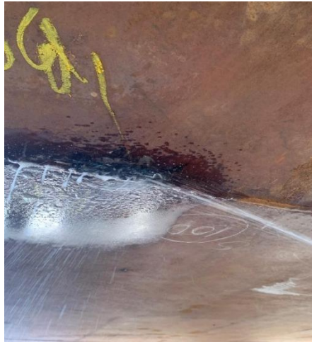
Gambar 4. 6 Hasil Akhir Pada Pengujian Ke 3 Air Pressure Test Tidak Menemukan Kebocoran (Gambar Pribadi)
