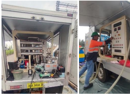
Gambar 6. Mesin purifikasi minyak transformator.
