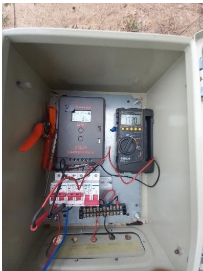
Gambar 26. Pengukuran tegangan panel surya menggunakan multimeter
