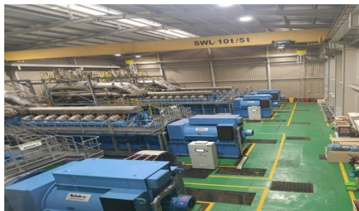
Gambar 1. PLTMG Maxpower Cogindo Batam 30 MW
