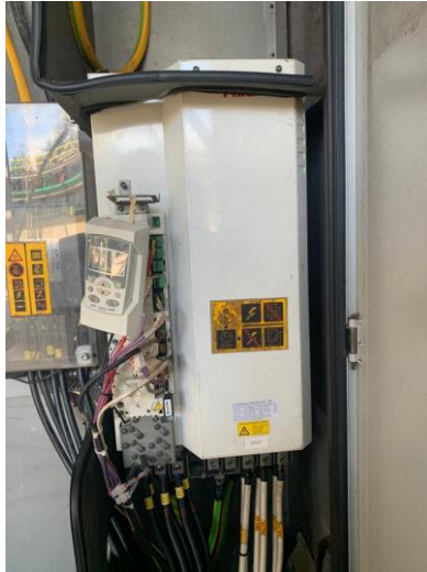
Gambar 3. 6 Variable Speed Drive yang digunakan
