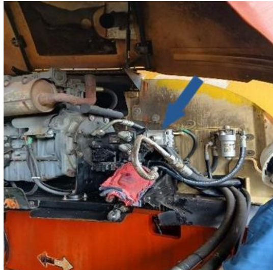
Gambar 4 : kebocoran pada pompa Hidrolik
