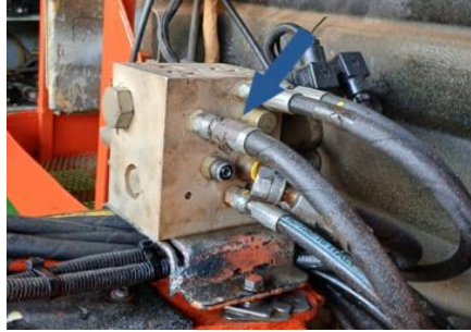
Gambar 6 : Kebocoran pada selang atau hose
