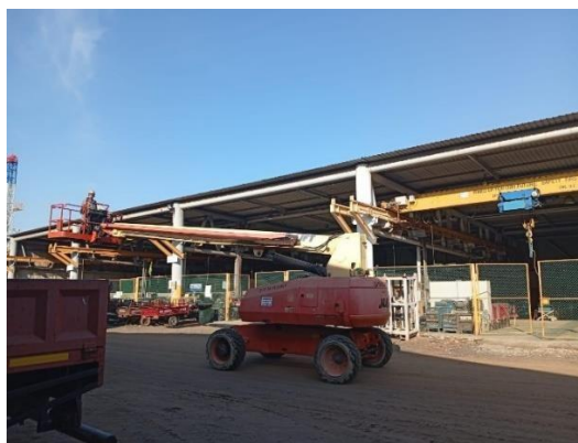
Gambar 2 : Mainlift – TB S800
