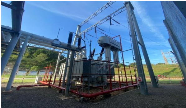
Gambar 11 Transformator di PT TJK POWER (sumber:dokumentasi pribadi)
