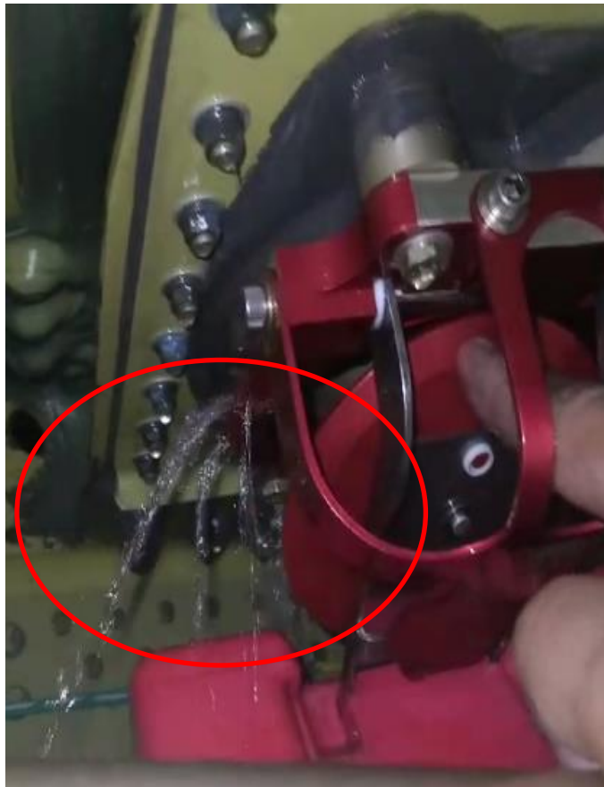
Gambar 5. Kebocoran pada Floating Valve
