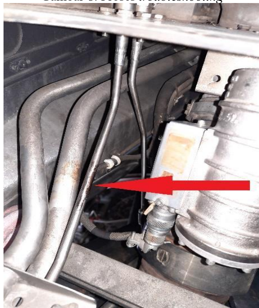
Gambar 9. Indikasi Kebocoran pada Sense Line Fan Air Valve
