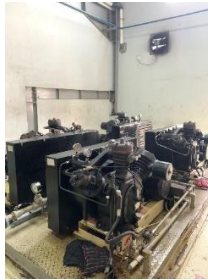
Gambar 8. Air compressor Ingersoll Rand PLTMG Panaran
