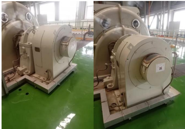
Gambar 8. Brushless Exciter Unit 1 dan 2 PLTU PT. Bintang Alumina Indonesia
