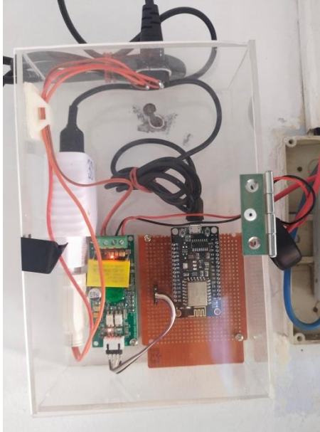
Gambar 9. Alat Monitoring Data Pemakaian Energi Listrik Rumahan Berbasis Iot
